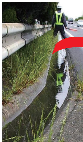
施工前冠水状況
